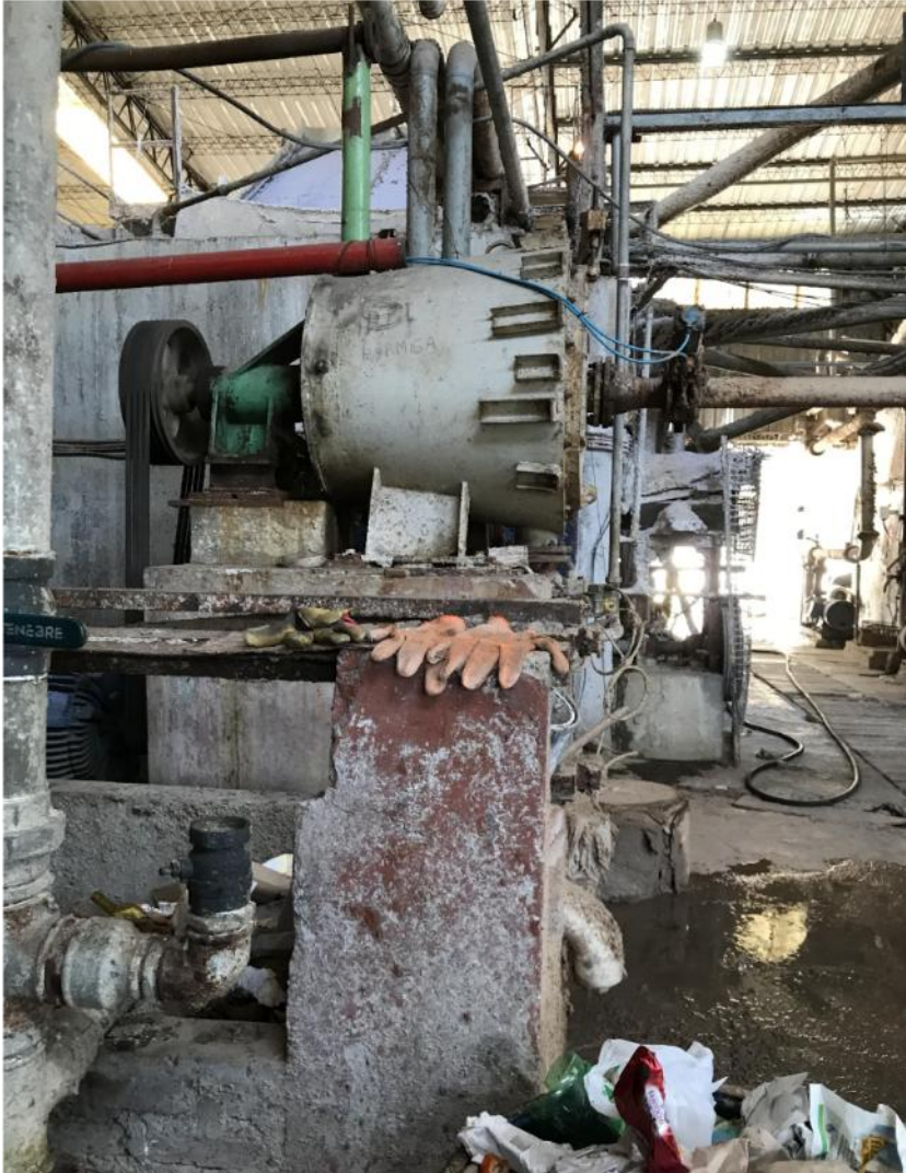
Figura 10. Ingreso a las tuberías para la pasta de papel kraft. Fotografía propia
