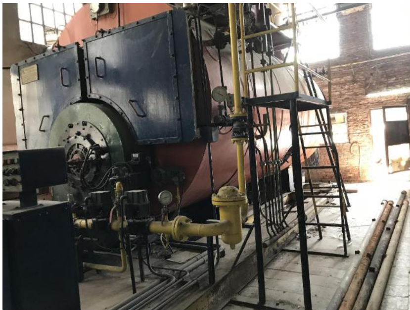
Figura 18. Sector calderas. Fotografía propia.
